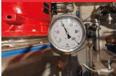
Eingangsdruck in der Zentrale des Trinkwasserkraftwerks Ernen.
